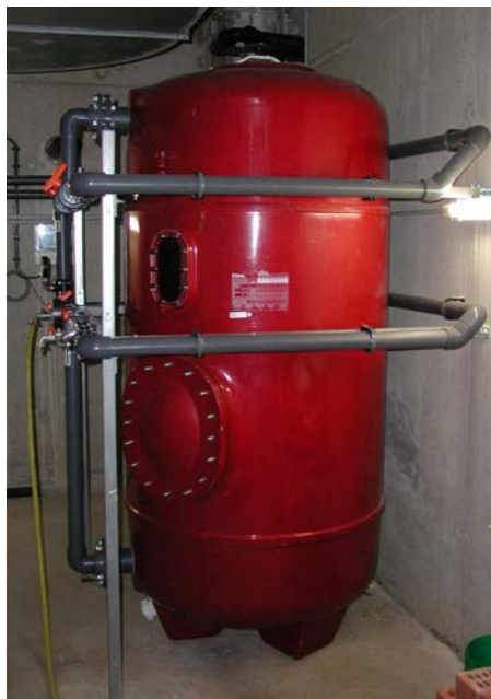
Abbildung 46: Im Bäderbereich genutzter spülbarer KleinfILTERKessel.
