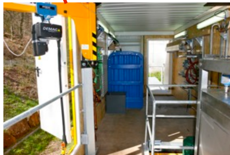
Chemikalienlager mit Servicekran
